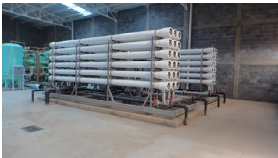
Bancos de ósmosis inversa.
