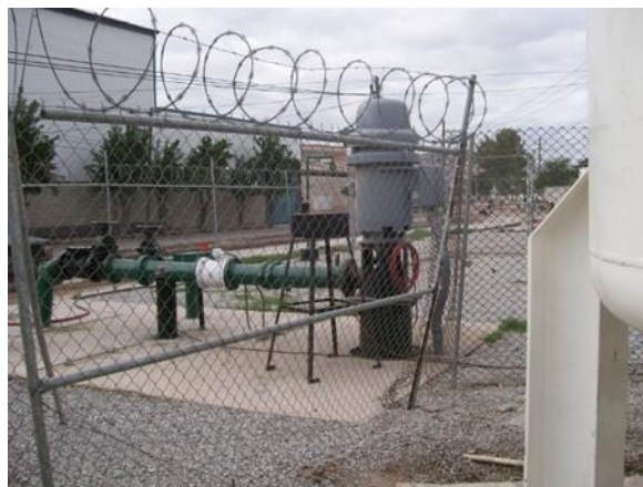
Pozo No. 12 y filtro, Gómez Palacio, Durango.
