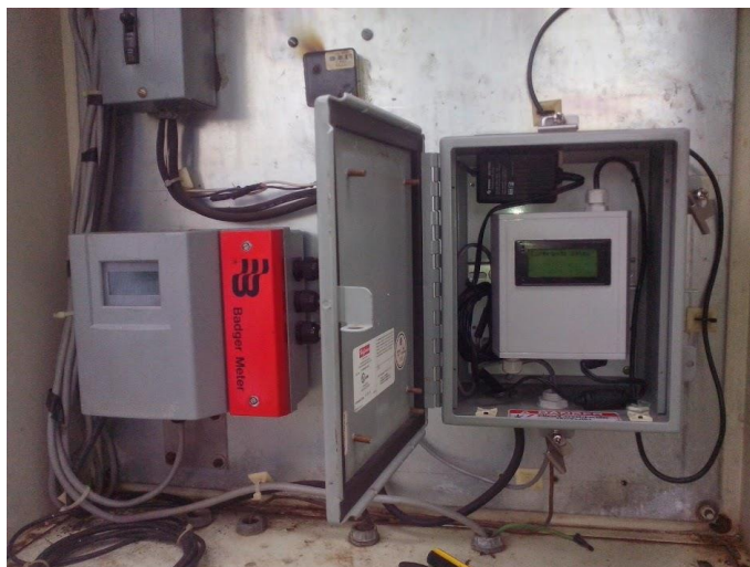
Sistema de adquisición remota de datos vía GSM, para una red de distribución de agua para prueba en la Estación Piloto Pozo IMTA.
