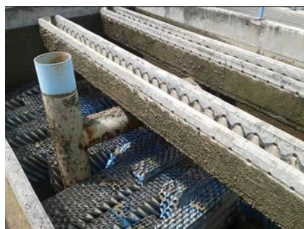
Estado actual de sedimentador en la planta potabilizadora Frontera.
