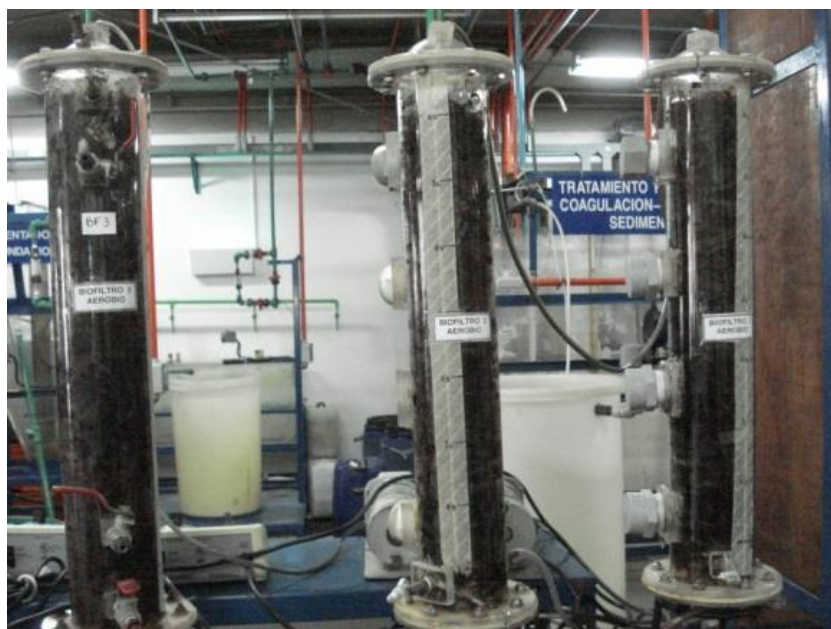
Sistemas de biofiltración para remover contaminantes emergentes.
