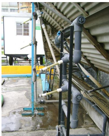
Panel donde fueron instalados los testigos de corrosión, en la torre de prueba de la Central Termoeléctrica del Valle de México.
