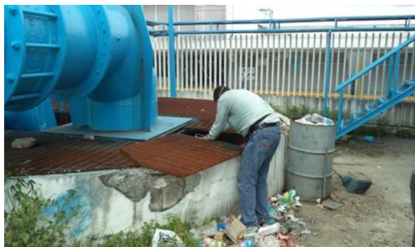
Obstrucción por desechos sólidos en cárcamos.
