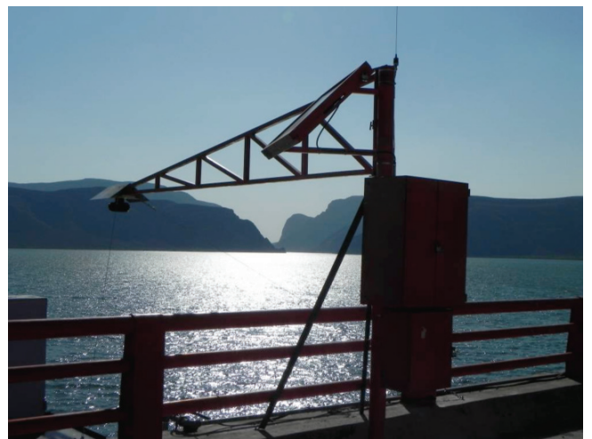
Sistema de medición de niveles.
