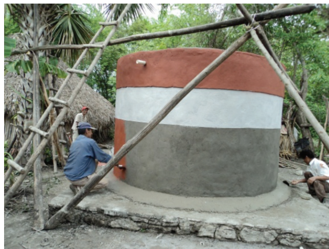
Cisterna de 11,000 litros en La Labor, municipio de Tanlajás, San Luis Potosí
