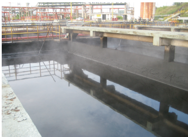
Separadores de efluentes aceitosos.
