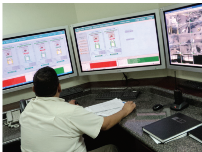
Sala de control telemétrico, Ciudad Juárez.
