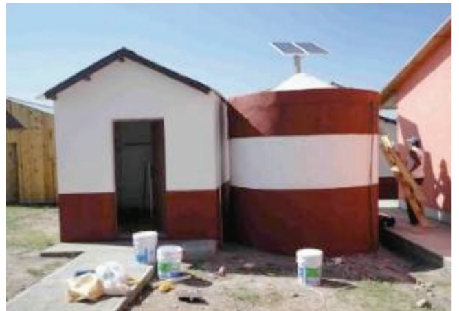
Caseta de planta potabilizadora y cisterna de almacenamiento de agua.
