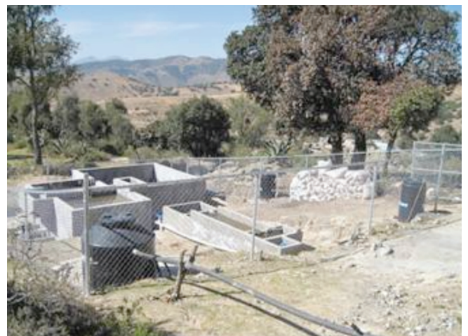
Vista panorámica de la planta FIME Peregrina.
