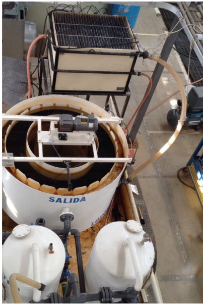
Vista de la planta piloto con reactor-floculador.
