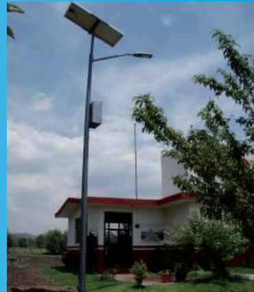
Luminaria solar en Santa Fe de la Laguna.
