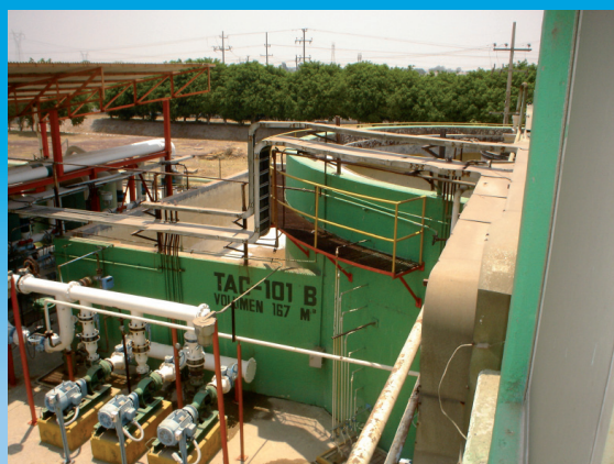
Clarifloculador y tanque de almacenamiento de la planta de tratamiento lateral de agua de enfriamiento de la CFE en Salamanca, Guanajuato.
