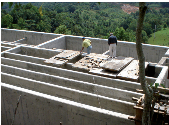
Vista de la cámara de floculación.
