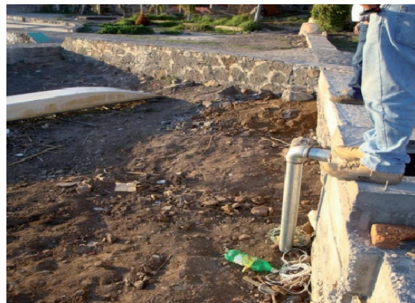
Entronque línea de tubería galvanizada de 3" de diámetro del bombeo al colector de Janitzio.
