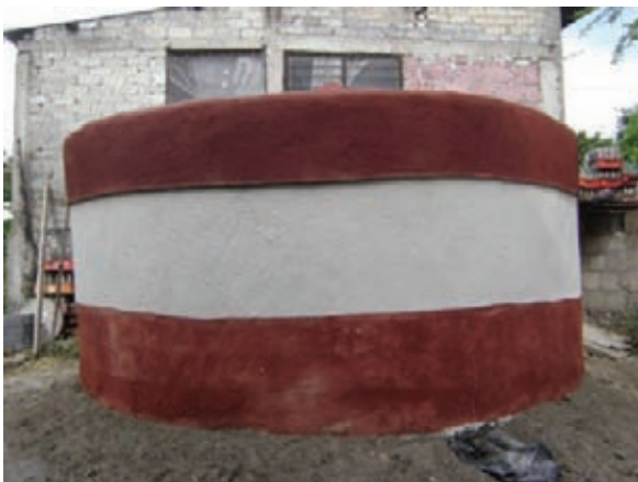
Cisterna de captación pluvial en la colonia Ampliación Miguel Hidalgo, Xochitepec.
