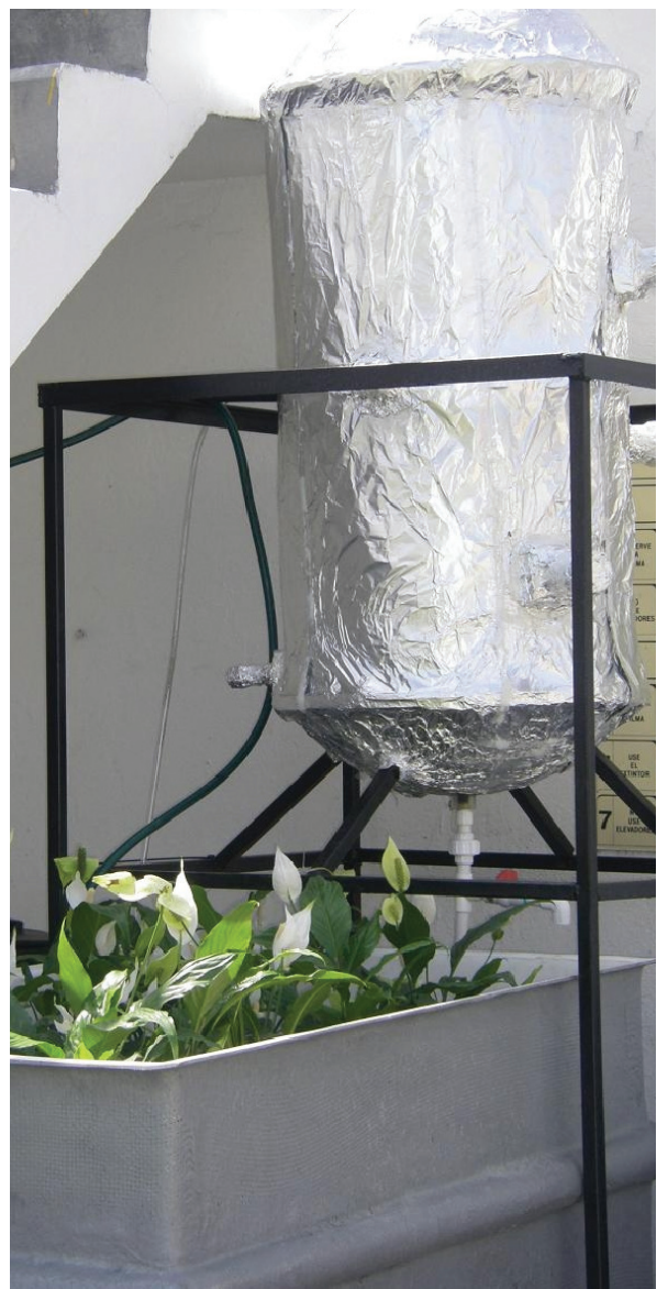
Tratamiento de aguas residuales domiciliario: Biofiltro+humedal.
