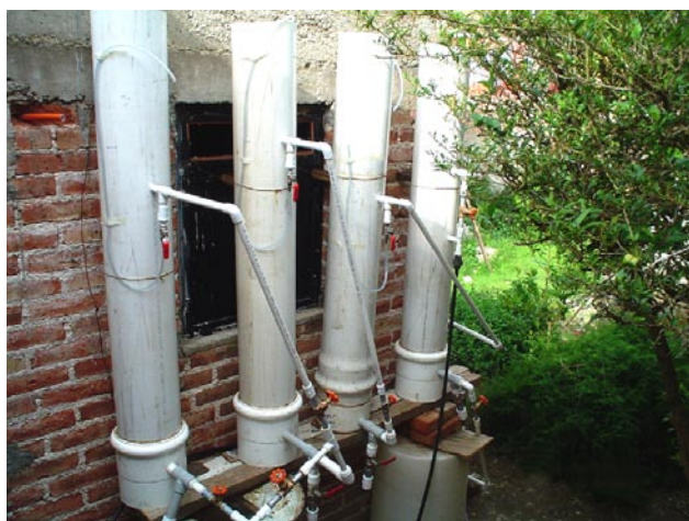
INSTALACIÓN PILOTO DE FILTRACIÓN EN MÚLTIPLES ETAPAS (FIME)
