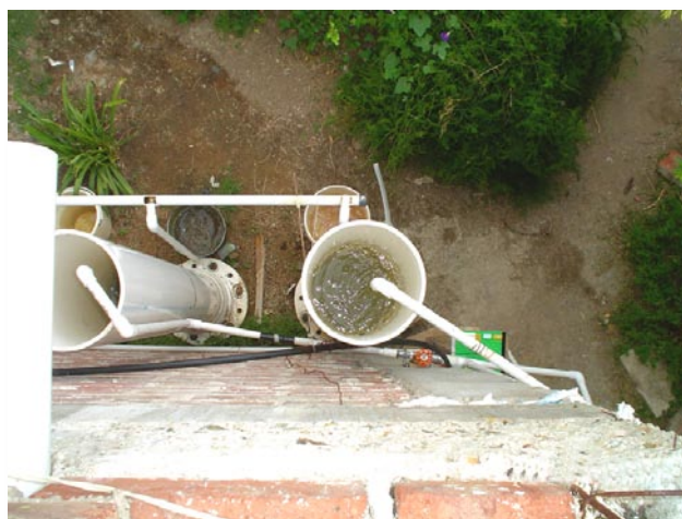
VISTA DE LA PRIMERA COLUMNNA (FILTRRO GRUESO)
