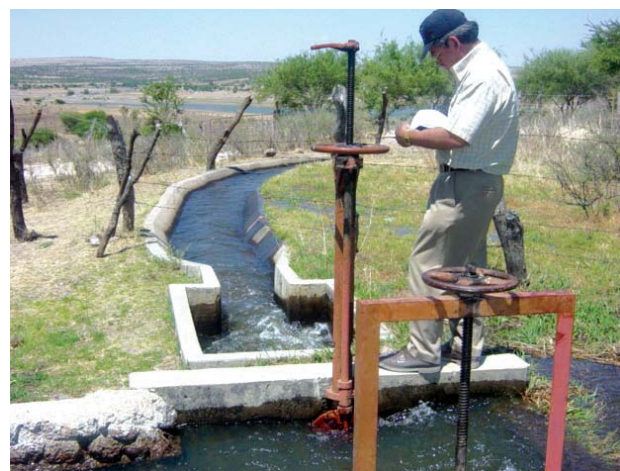
PROYECTO EJECUTIVO PARA LA UNIDAD DE RIEGO PRESA 50 ANIVERSARIO, SAN JOSÉ DE GRACIA, AGUASCALIENTES
