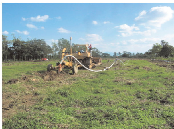
INSTALACIÓN DEL SISTEMA DE DRENAJE SUBTERRÁNEO CONTROLADO PARCELARIO EN EL DTT 001 LA SIERRA, TABASCO
