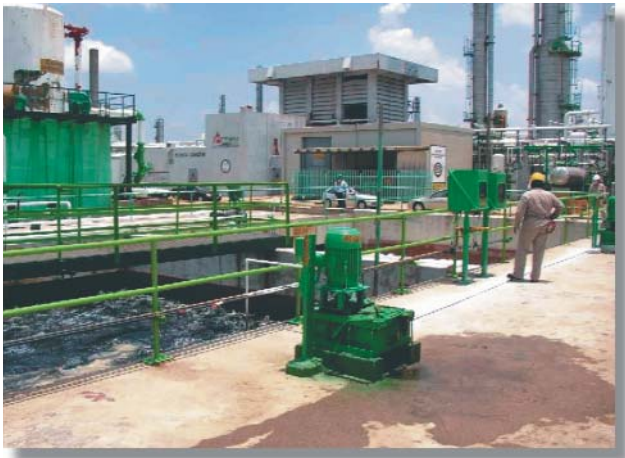
DESCARGA DEL DRENAJE QUÍMICO EN PETROQUÍMICA PAJARITOS, S.A. DE C.V.
