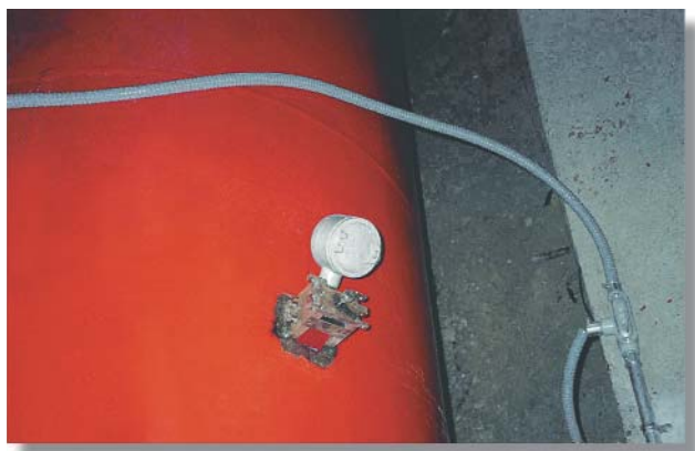
SENSOR ULTRASÓNICO EN EL TUBO DE LA OBRA DE TOMA DE LA PRESA EL TINTERO, CHIHUAHUA
