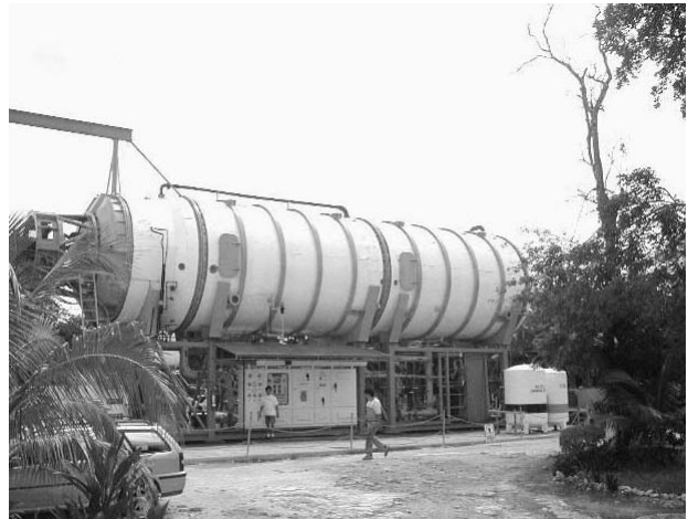
PLANTA DESALADORA POR COMPRESIÓN DE VAPOR EN COZUMEL, Q.R.
