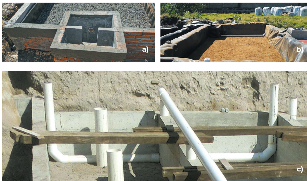
Figura 41. Instalación de tuberías en el humedal de flujo subsuperficial horizontal: a) ingreso a la caja de entrada, b) tubo de salida en el fondo del estanque, c) tubo de interconexión entre dos estanques contiguos.
