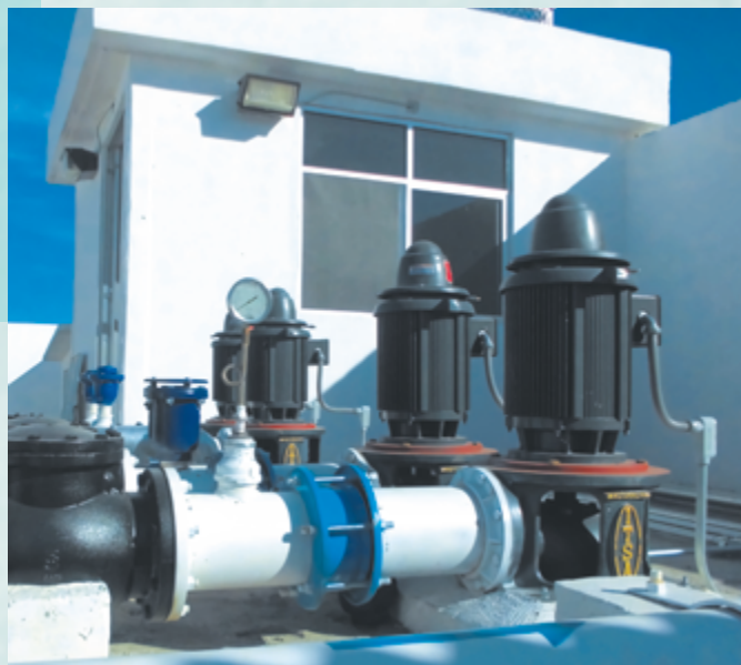
Equipos de bombeo.
