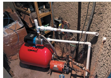
Equipo de bombeo hidroneumático en el edificio de Hidráulica.
