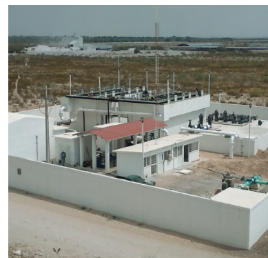
Construcción de planta de filtración directa de 193 L/s para pozos Transportes I y III, en Gómez Palacio, Durango.
