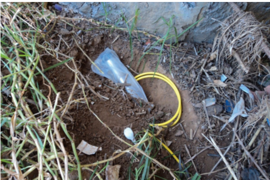
Figura 2. Dispositivo de registro de nivel (levellogger) GlobalWater instalado en Dren Tzurumútaru
