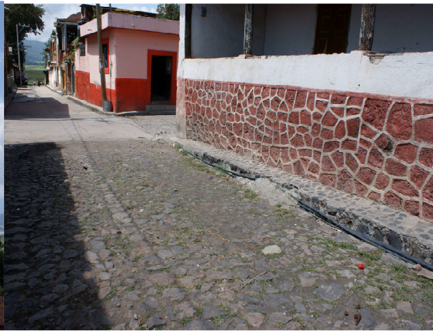
Manguera de agua potable sobre una calle
