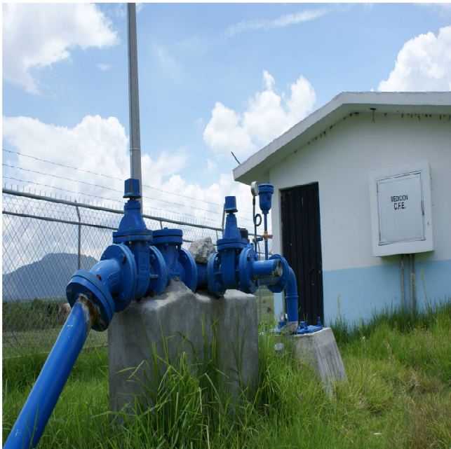
Pozo de agua profunda de Jarácuaro
