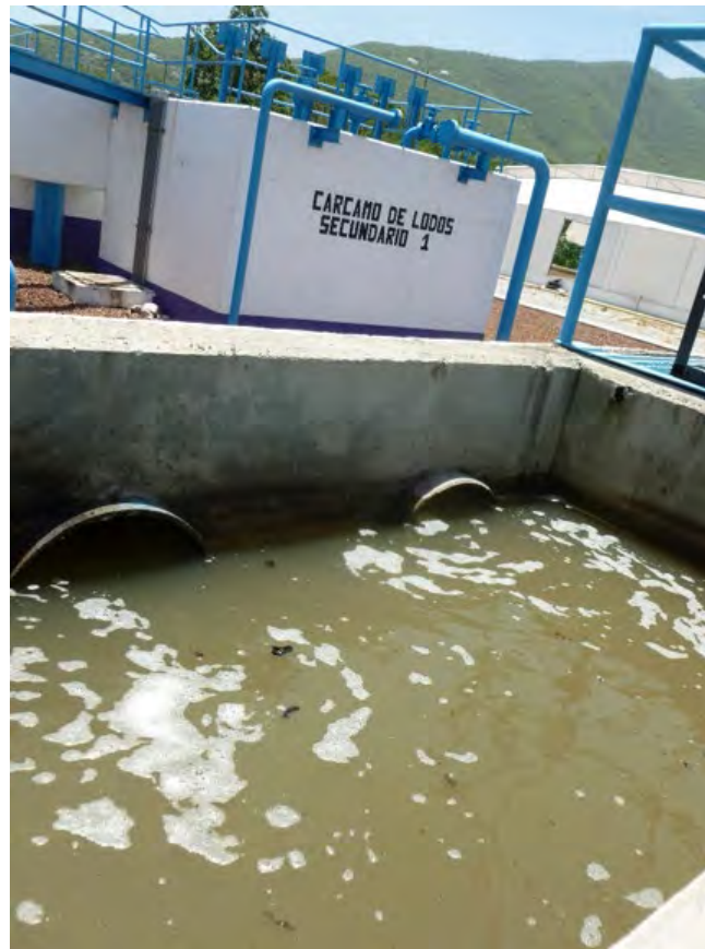
Figura 8.4. Planta de tratamiento de aguas residuales municipales en la cuenca del río Apatlaco.
